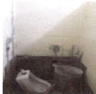
Foto 4: Servicio sanitarios y sus accesorios
